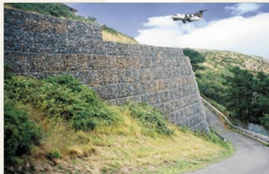
19 metrowa ściana grawitacyjna z gabionów zbudowana w roku 1968 na terenie lotniska Jersey na wyspach Kanalu La Manche.
